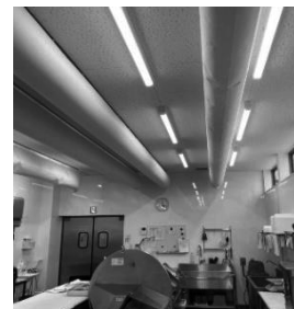
作業員・商品に直接冷気が当たらない空調システム
